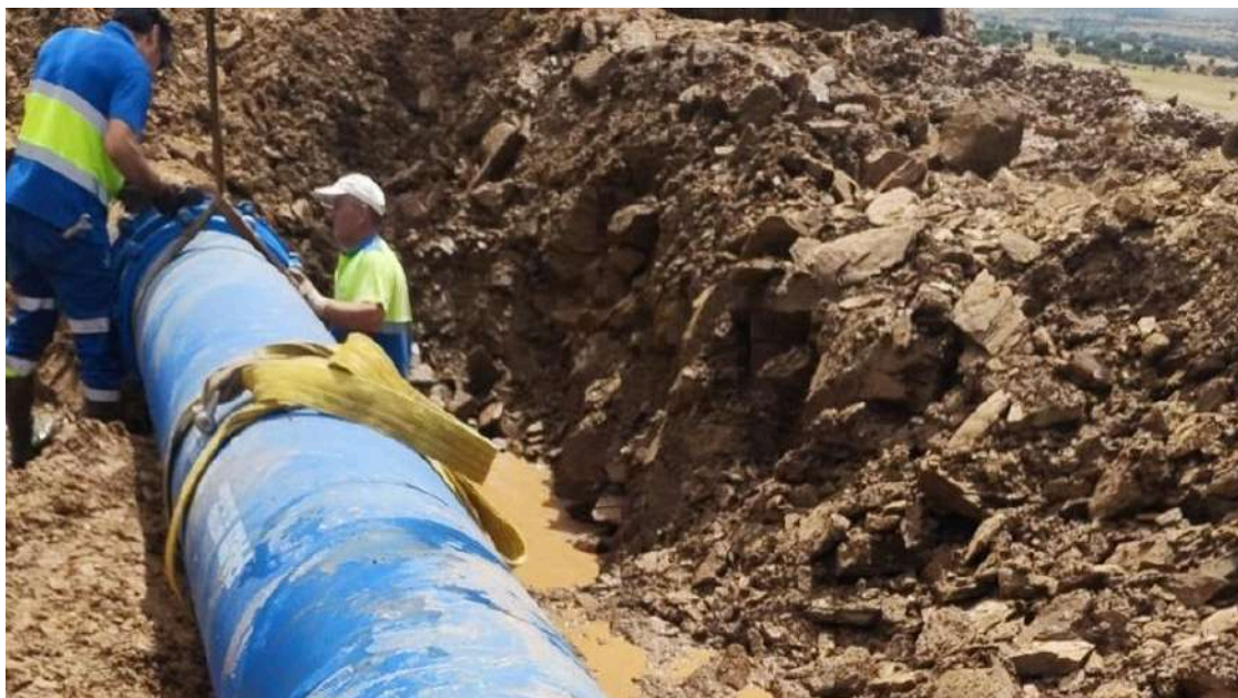
Rotura en una tubería principal, el martes.
