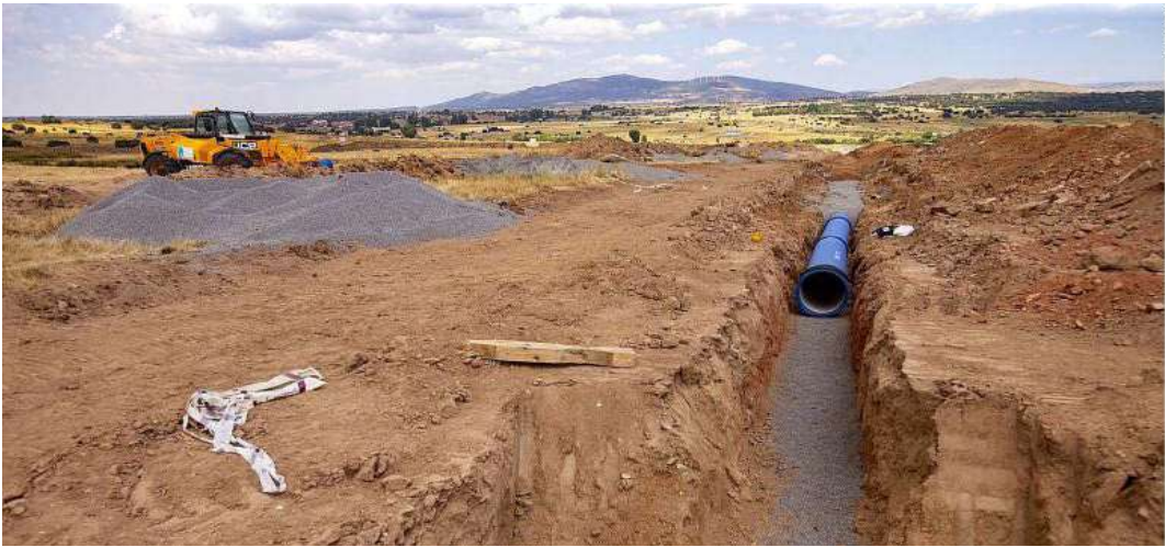
Los problemas empezaron el pasado jueves cuando una retroexcavadora que trabajaba en las obras de ampliación del polígono de Vicolozano rompió una tubería. / DAVID CASTRO
